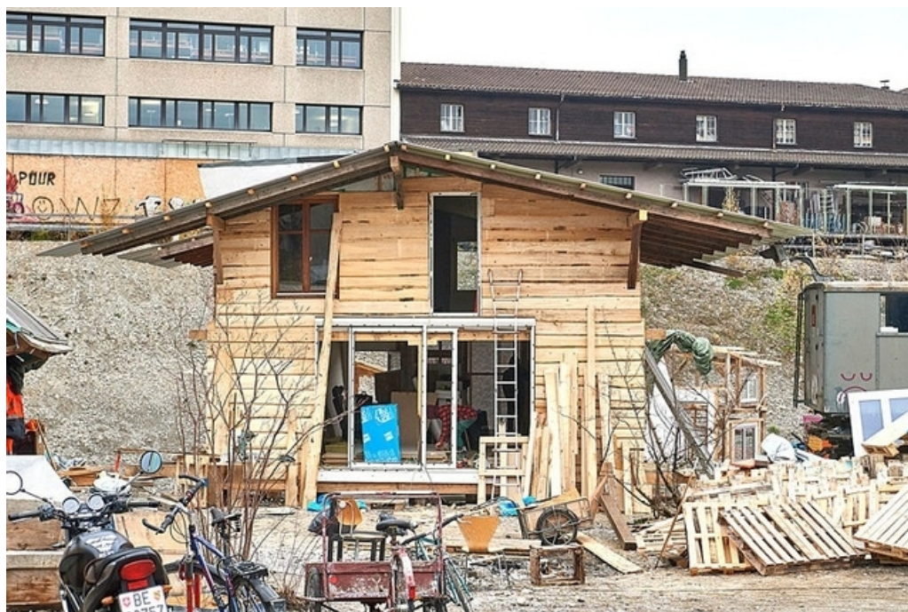
Die Besetzer des Warmbächli-Areals mussten sich nicht mit Einsprachen herumschlagen: Bau des Gemeinschaftshauses Ende November. Bild: Adrian Moser
